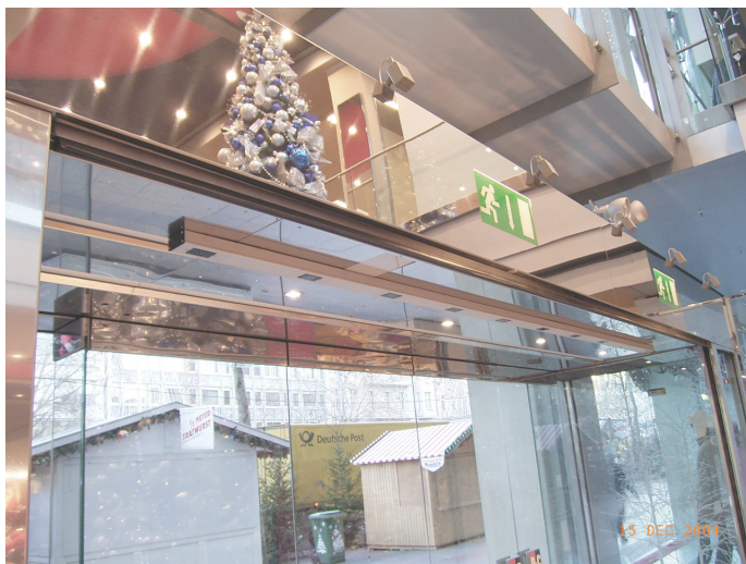
Capteurs installés dans l'entrée.
